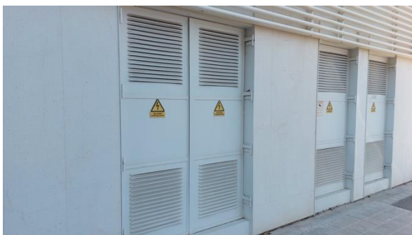
Entrada al centro de Transformación en C/ Suiza
